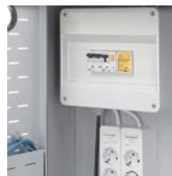
Màxima seguretat elèctrica
